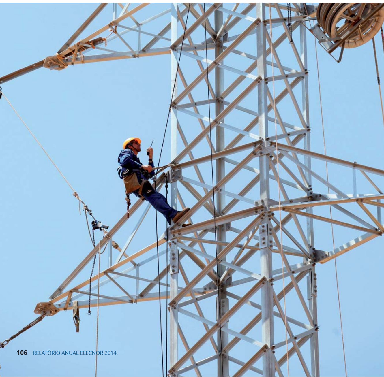
Linha Aérea Alta Tensão Duplo Circuito 45 kV Alarcos- Piedrabuena (Madri)
