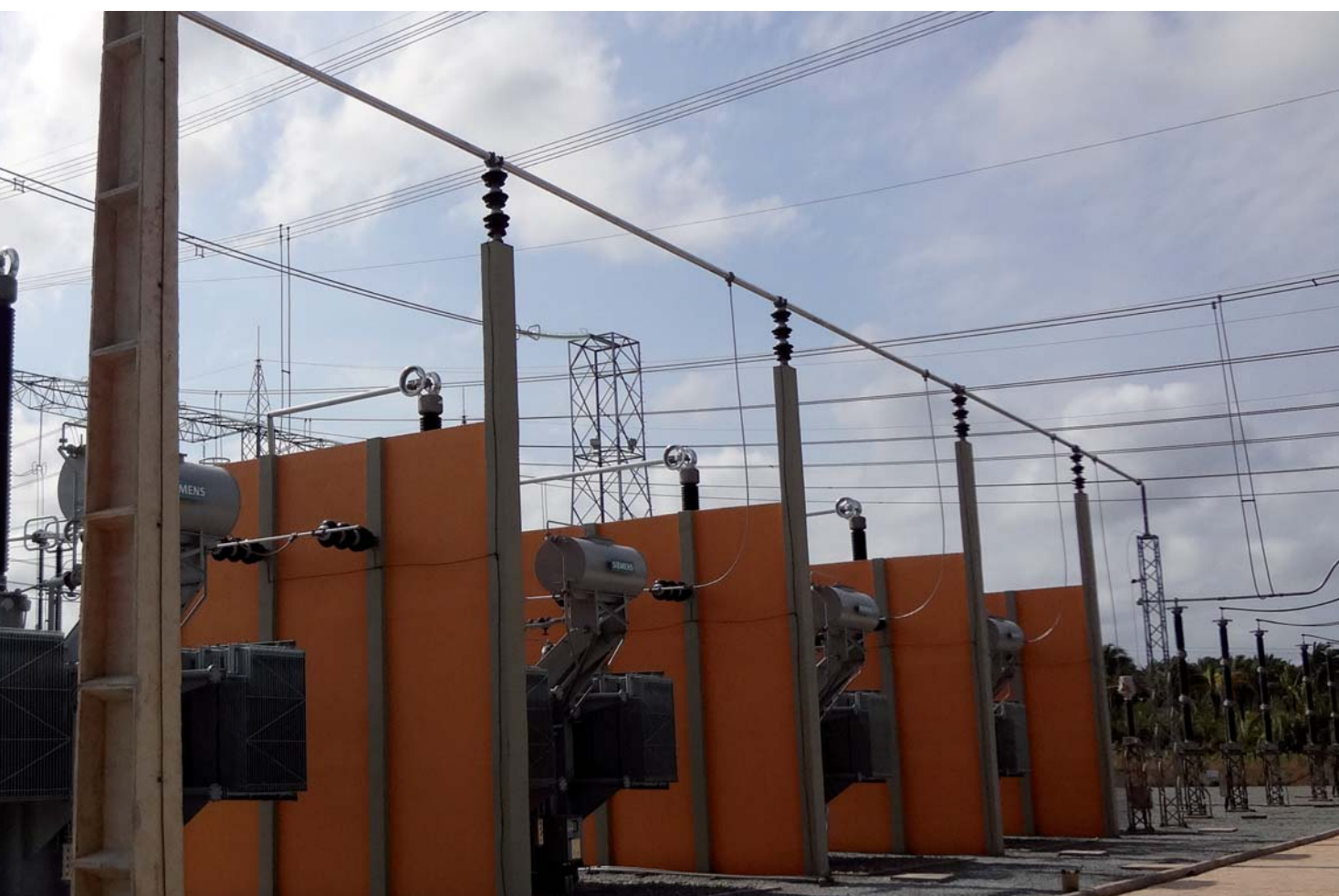
Subestação Miranda II (Brasil)
