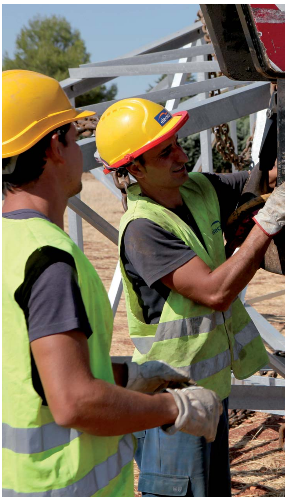
Linha Aérea Alta Tensão Duplo Circuito 45 kV Alarcos-Piedrabuena (Madri)
