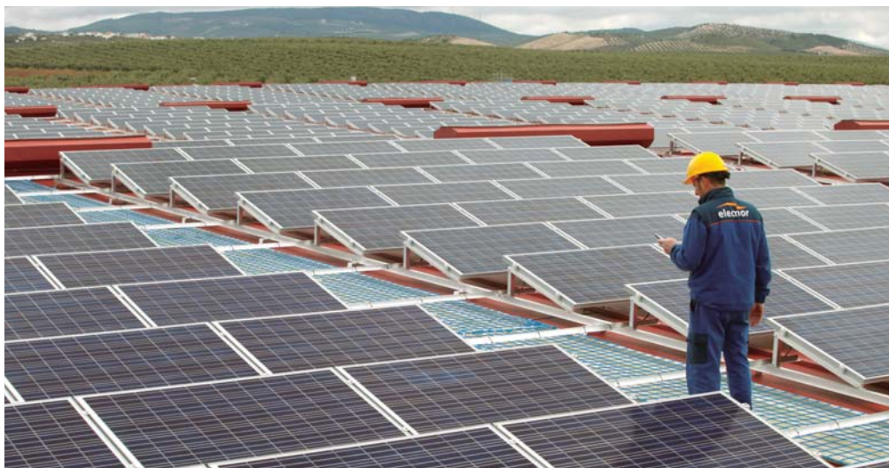
Cobertura fotovoltaica na instalação de Puertas THT em Antequera (Málaga)
