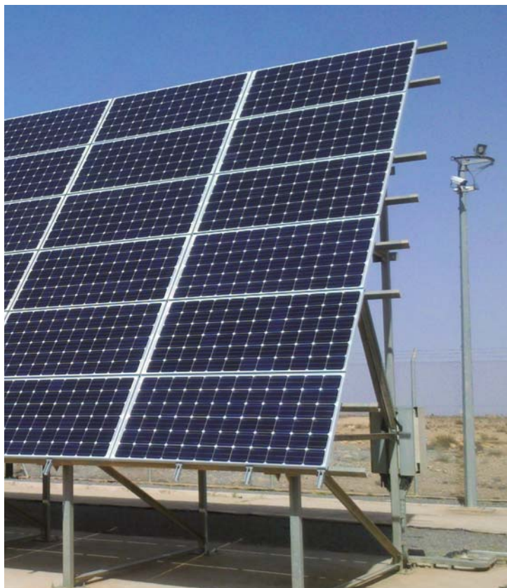
Instalação solar para proteção catódica e controle de válvulas de gasoduto. Remodelação do gasoduto Metragaz (Marrocos)
