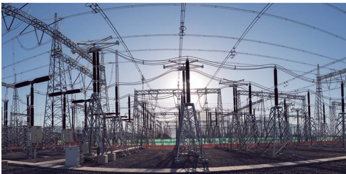
Subestação Alto Jahuel 500 kV (Chile)
