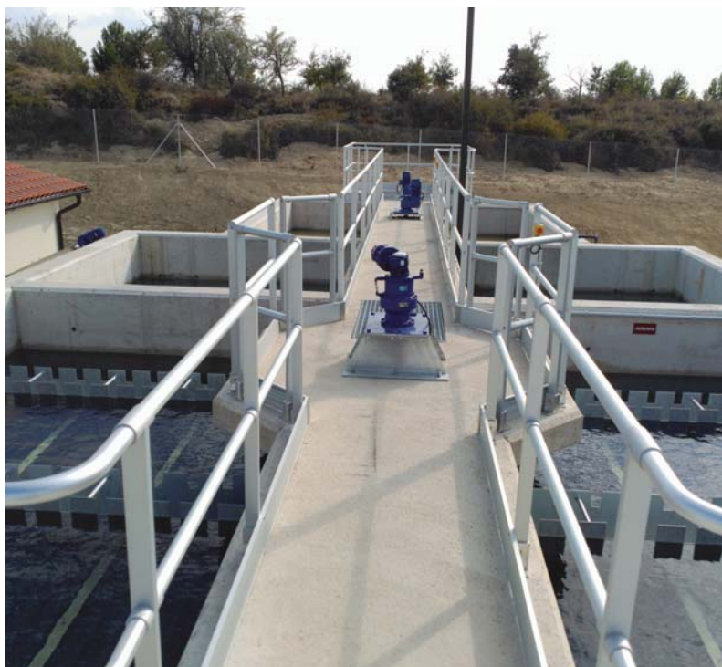
ETAP La Pedrera em Tafalla (Navarra). Hidroambiente
