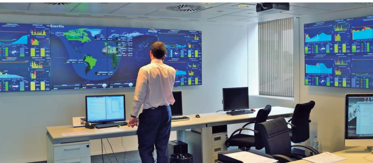
Centro de Controle de Usinas Eólicas (Madri). Enerfín
