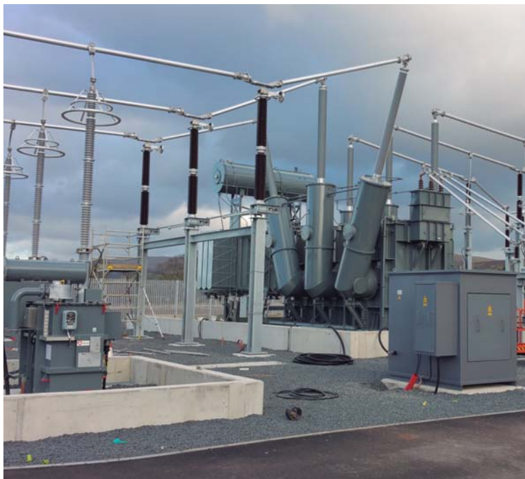
Subestação Hunterston North na Escócia (Reino Unido). IQA
