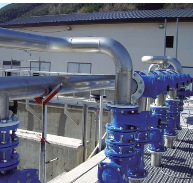
Biescas WWTP (Huesca). SAPIR
