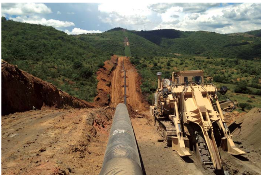
Morelos gas pipeline (Mexico)
